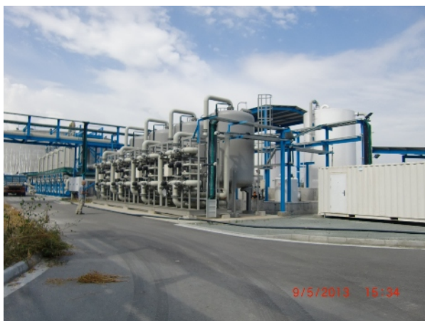
ΕΙΚΟΝΑ 3: Αφαλάτωση Επισκοπής
